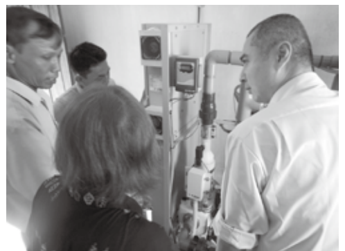
最終メンテ(海水電解浄化装置)
