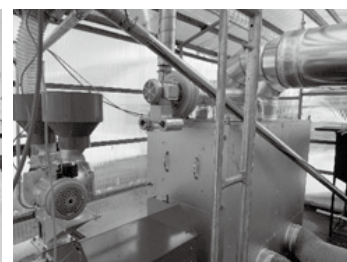
ペレット暖房設備
