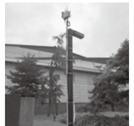
【LPWA通信システム 基地局】
